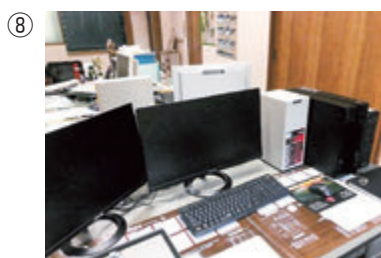
集中制御システム設置 (コース管理事務所)
